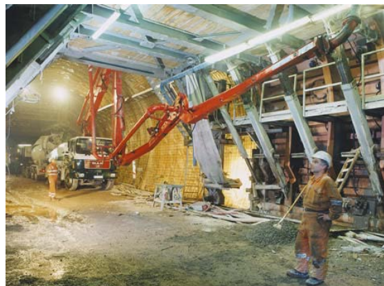
پمپ بتن تونل
